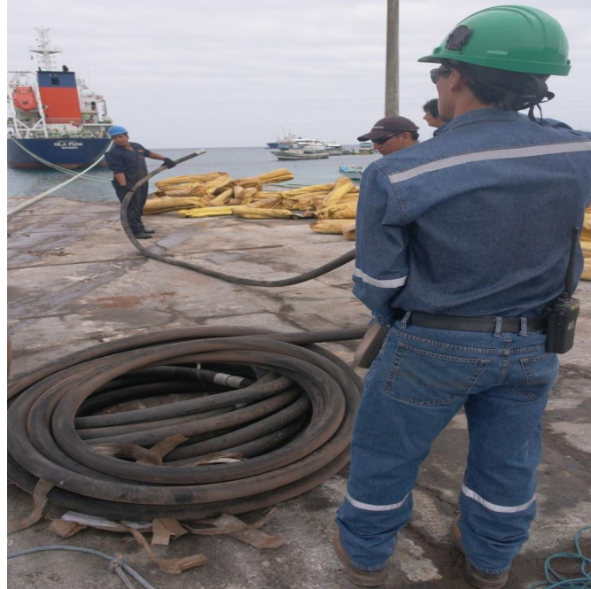
A# 33 Conexión de las mangueras al BT 1
