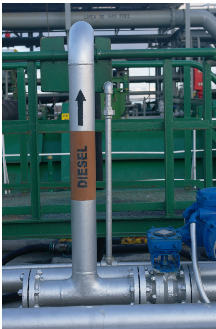
A# 24 Tubería Puerto Seymour 1
