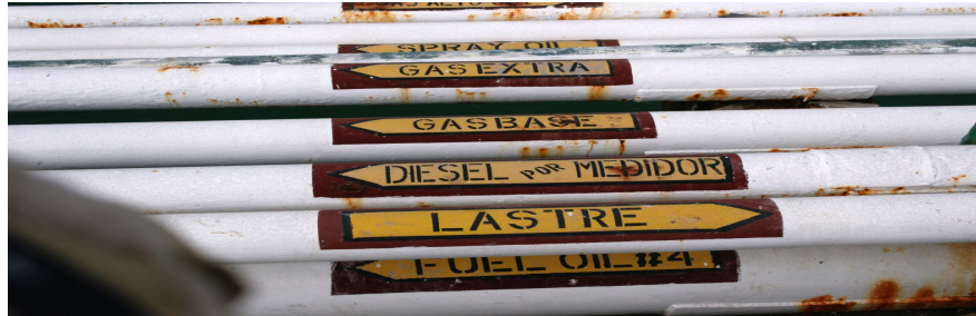
28 imagen #26 Tuberías varias petroleo 1
